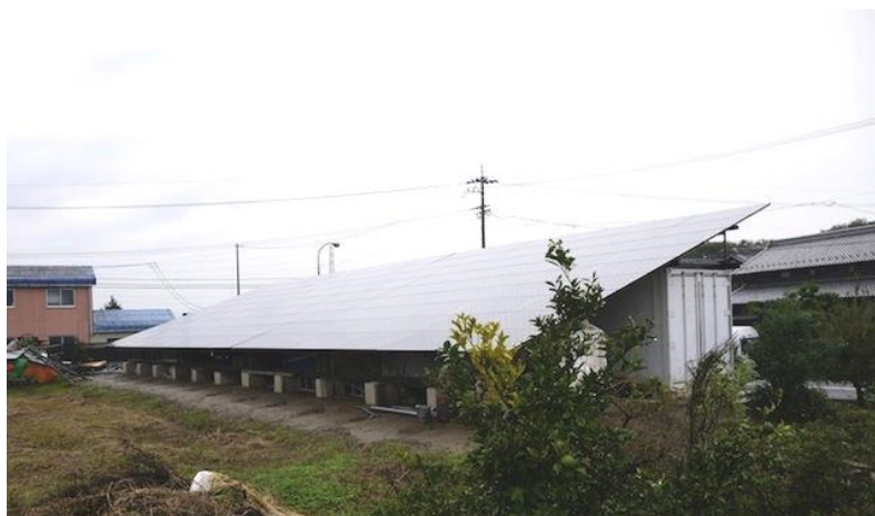
完成した太陽光発電装置
